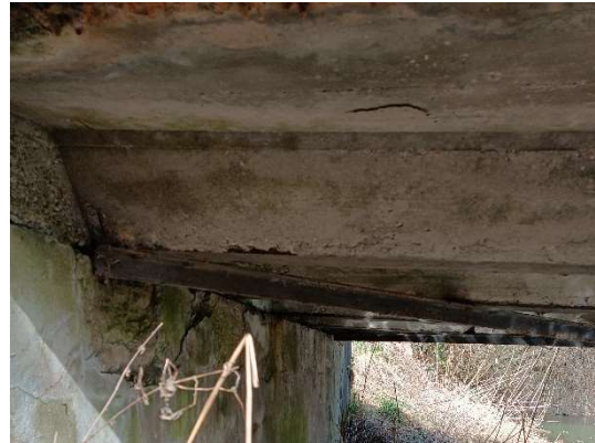
Untersicht Brücke, Hauptträger sehr stark korrodiert. Insbesondere auch im Auflagerbereich.
