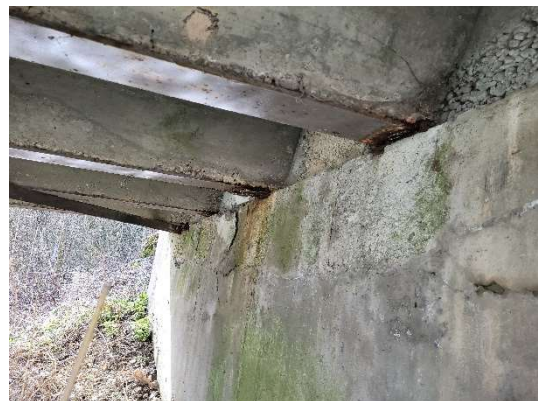
Untersicht Brücke, Hauptträger sehr stark korrodiert. Insbesondere auch im Auflagerbereich. Beton in schlechtem Zustand, grosse Kiesnester und Abplatzungen aufgrund von Koorsion
