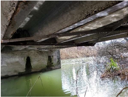
Untersicht Brücke, Hauptträger sehr stark korrodiert. Beton in schlechtem Zustand, grosse Kiesnester und Abplatzungen.
