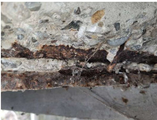
Detail Korrosion bei Hauptträger. Beton in schlechtem Zustand, grosse Kiesnester und Abplatzungen aufgrund von Koorsion
