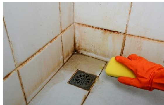
Abbildung 1: Roter Schimmel im Badezimmer (Gesund Wohnen; 2023)
